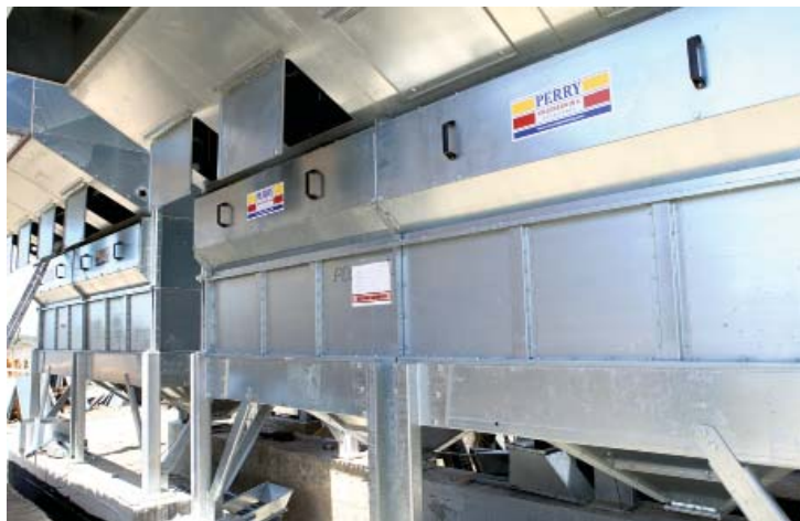
Сушильне обладнання зблизька
